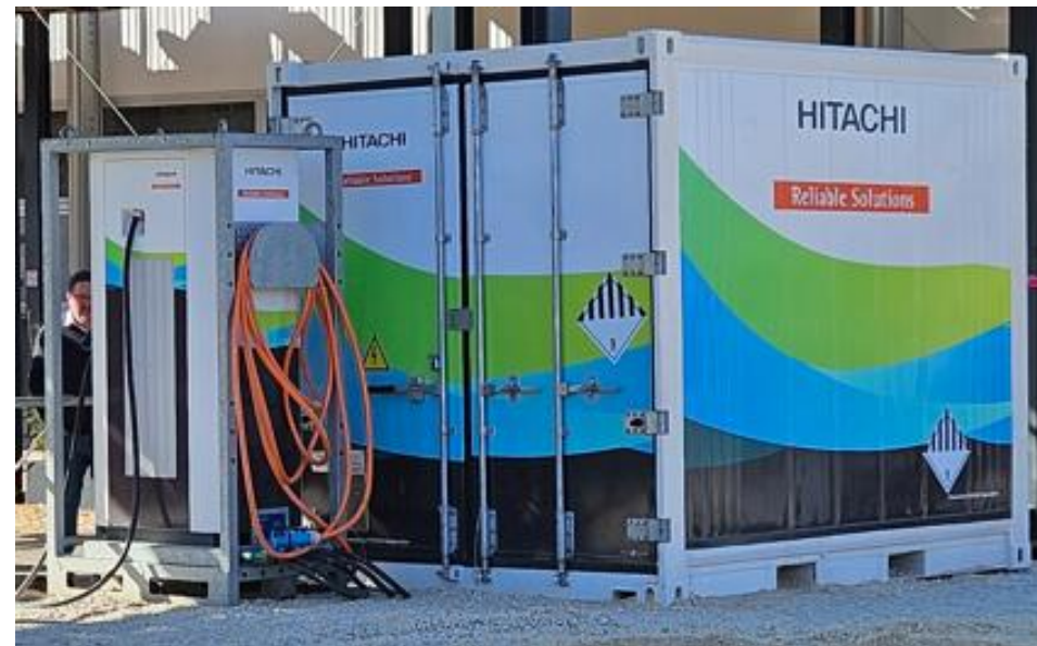
Een batterijcontainer voedt een DC-lader (in een frame gebouwd)
